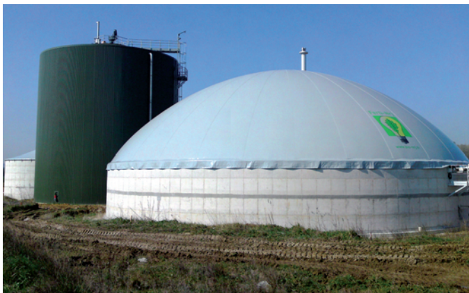
Abb. 4: Nachgärer mit Gasspeicher, im Hintergrund ein Hochfermenter
